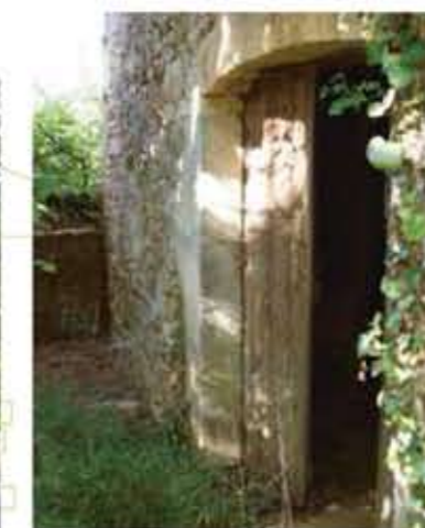
Ci-dessus Cette grange-bergerie bâtie en calcaire présente des encadrements d'ouvertures et des chaînes d'angle en pierre de taille.
